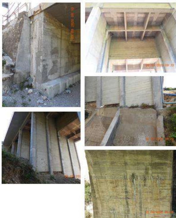
Figura 92 - Documentazione fotografica dei difetti del Viadotto Olivieri.
